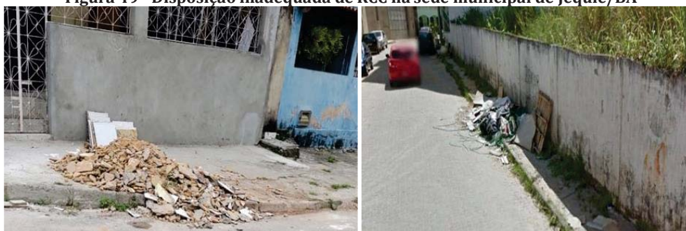
Figura 49 - Disposição inadequada de RCC na sede municipal de Jequié/BA
