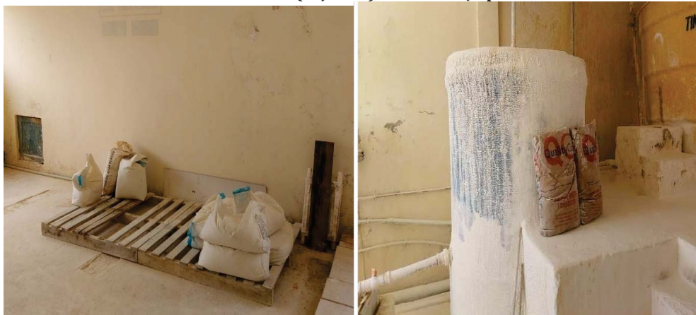
Figura 45 - Produtos químicos para tratamento de água da ETA da Barragem do Rio Preto do Criciúma (Cajueiro) da Sede de Jequié
