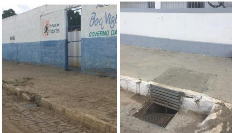
Figura 98 - Boca de Lobo na rua Laudelino Santos
