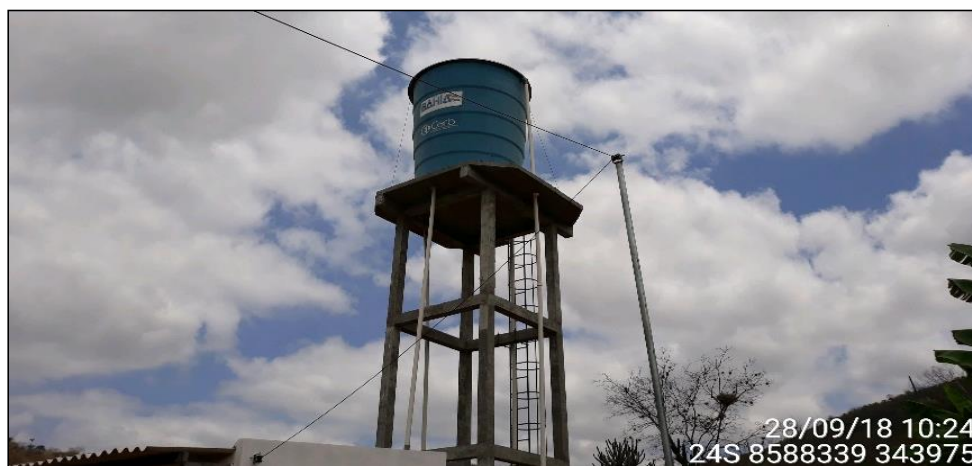
Figura 50- Reservatório do SAA Macambira
