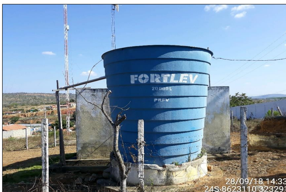
Figura 57- Estrutura de Reservação do Povoado de Amparo (Zuca)
