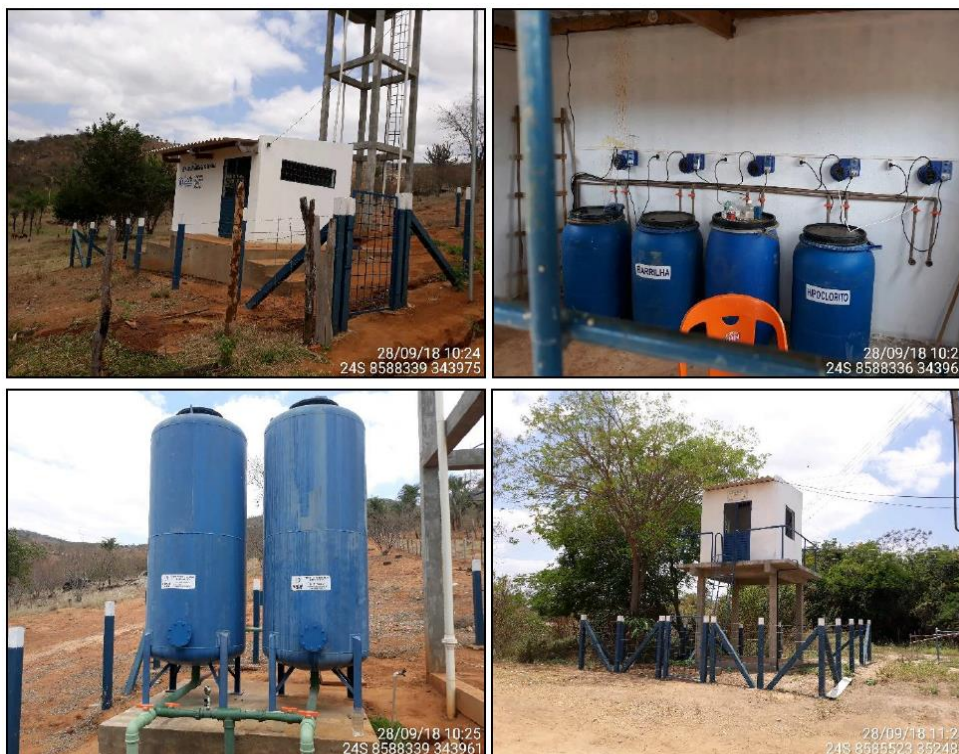
Figura 49- Detalhe da ETA Macambira
