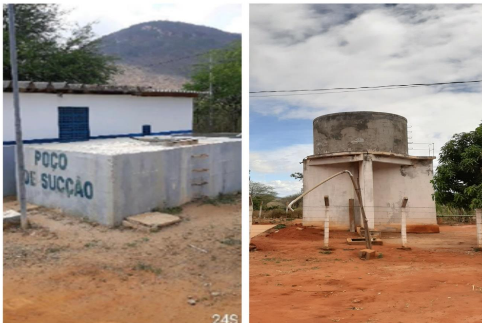
Figura 36- Estrutura de Reservação do SAA Baixo
