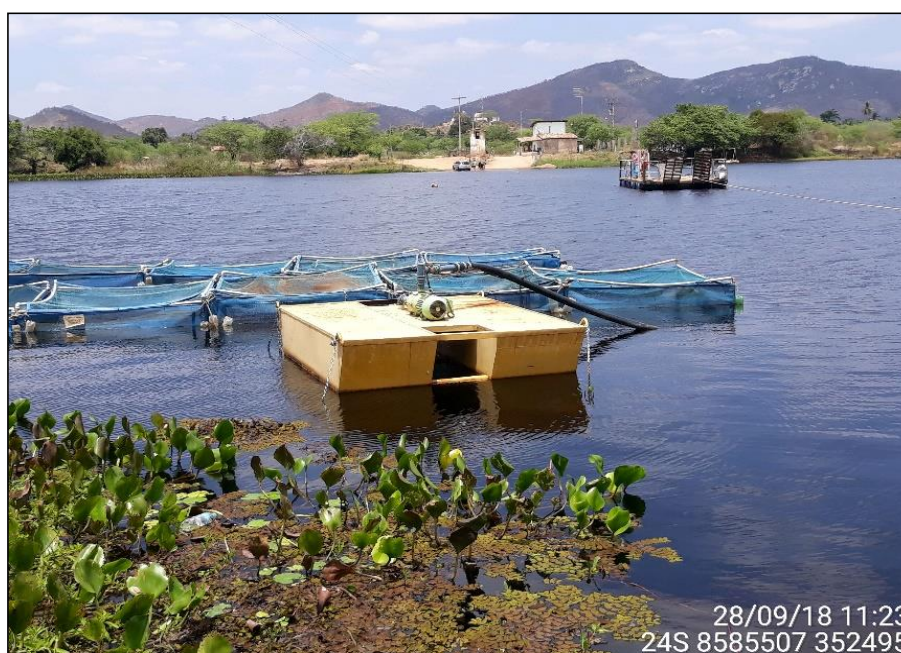
Figura 47 - Local de Captação de água do SAA de Macambira
