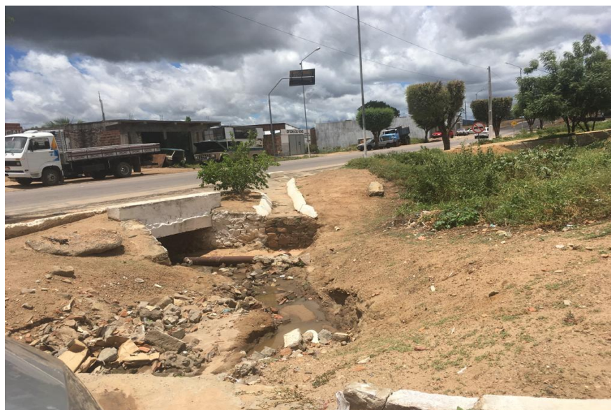
Figura 78- Lançamento clandestino de esgoto no dispositivo de drenagem na travessia na BA-130
