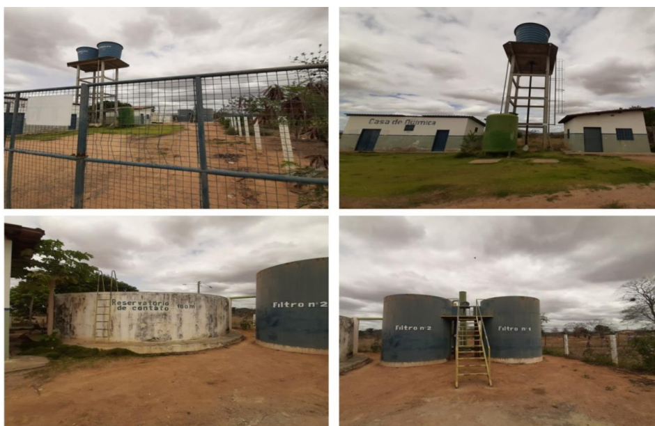
Figura 40- Detalhe da ETA Terra Boa
