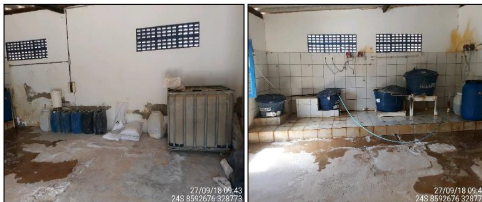
Figura 32- Detalhe do armazenamento e utilização de produtos químicos na ETA de Boa Vista do Tupim
