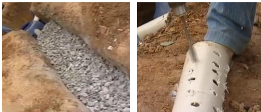
Figura 149 – Vala de infiltração para disposição do efluente da fossa séptica econômica
