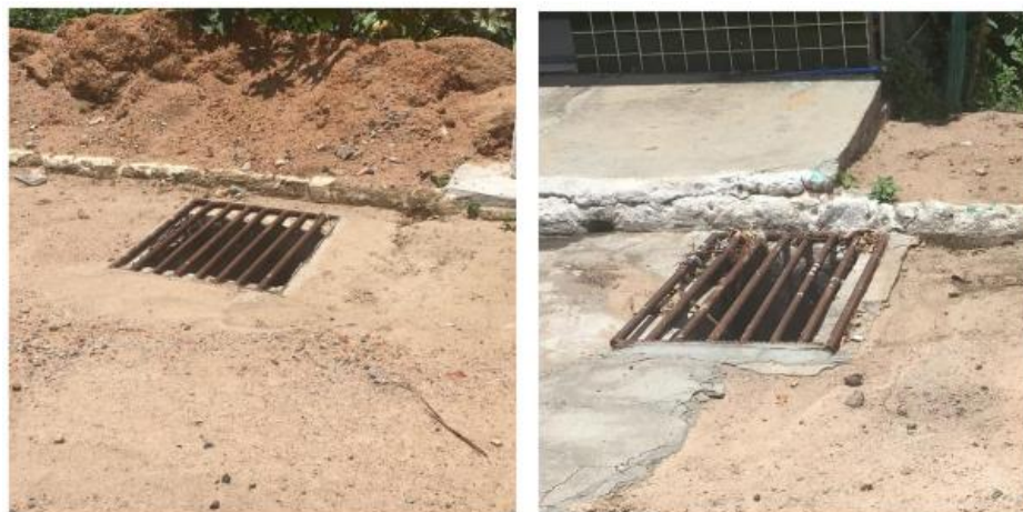
Figura 97 - Boca de Lobo na entrada da cidade pela BA-130 - Boa Vista do Tupim/BA
