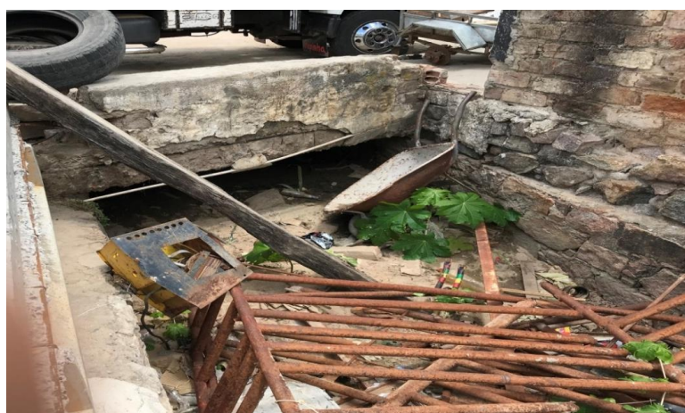
Figura 101- Obstrução de estrutura de drenagem por resíduos volumosos- Boa Vista do Tupim/BA
