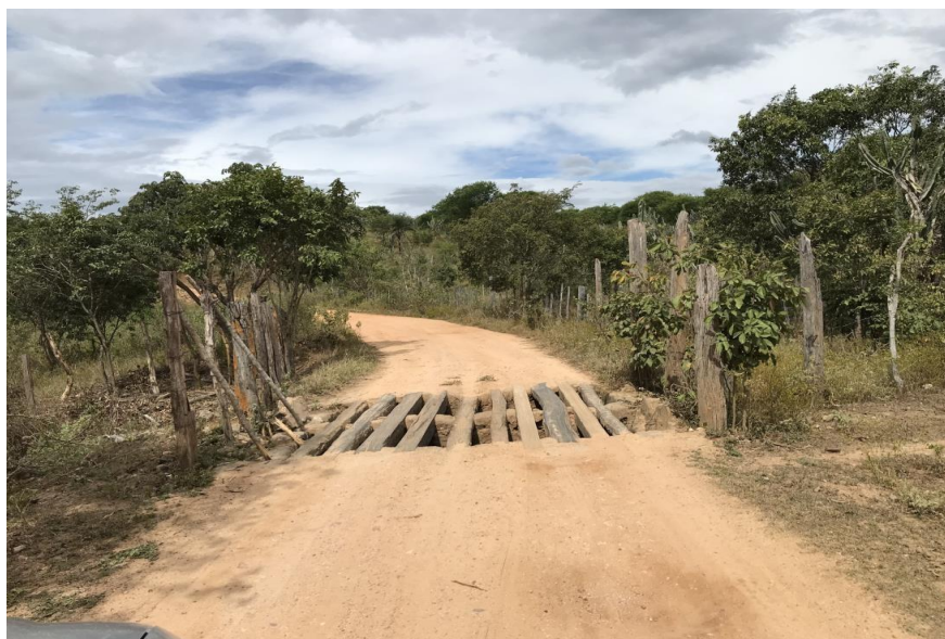
Figura 36: Trecho 02 – Mata burro a ser substituído - (Coord. 306664/8596542)
