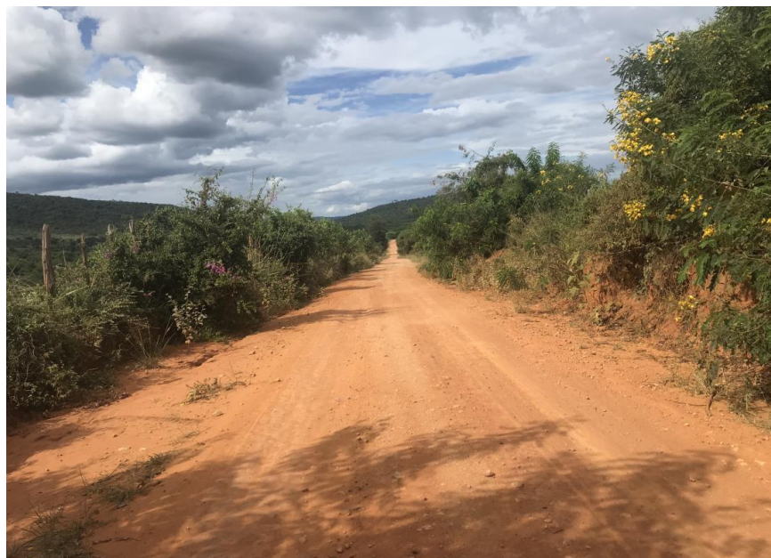
Figura 54: Trecho 03 - Ponto do trecho a ser recuperado (Coord. 315985/ 8599664)
