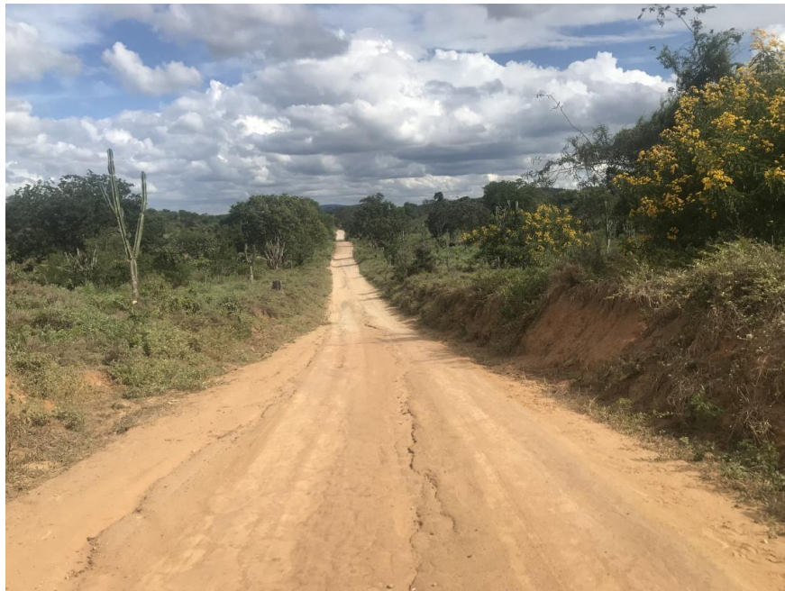
Figura 57: Trecho 03 - Ponto do trecho a ser recuperado (Coord. 318115/ 8599412)
