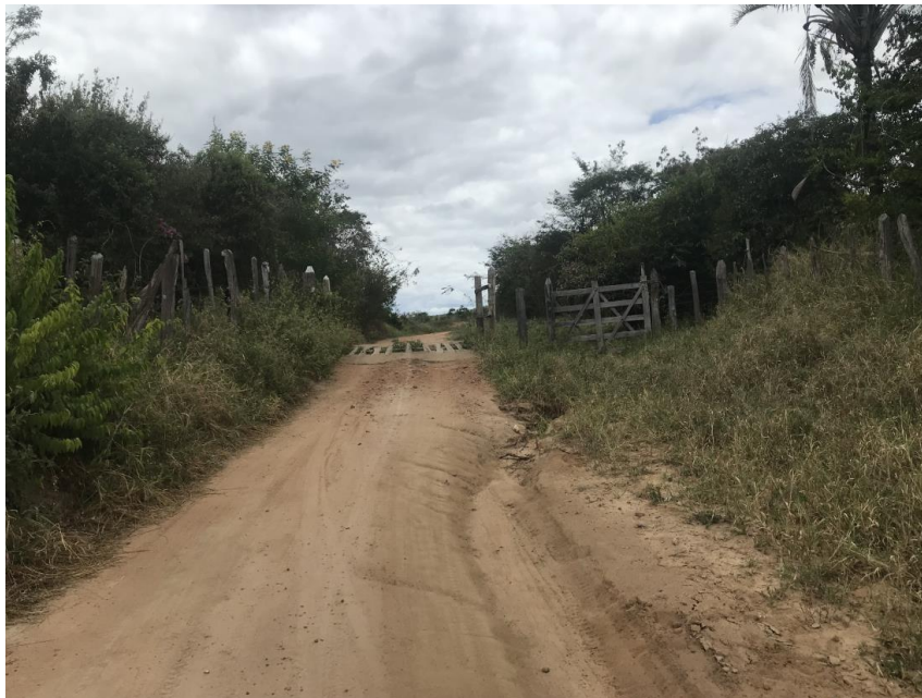
Figura 09: Trecho 01 – Mata burro a ser substituído - (Coord. 293589/8585288)
