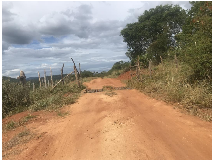
Figura 53: Trecho 03 - Mata burro a ser substituído - (Coord. 315059/ 8599232)
