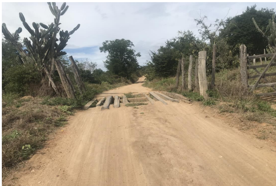
Figura 58: Trecho 03 - Mata burro a ser substituído - (Coord. 318379/ 8599234)
