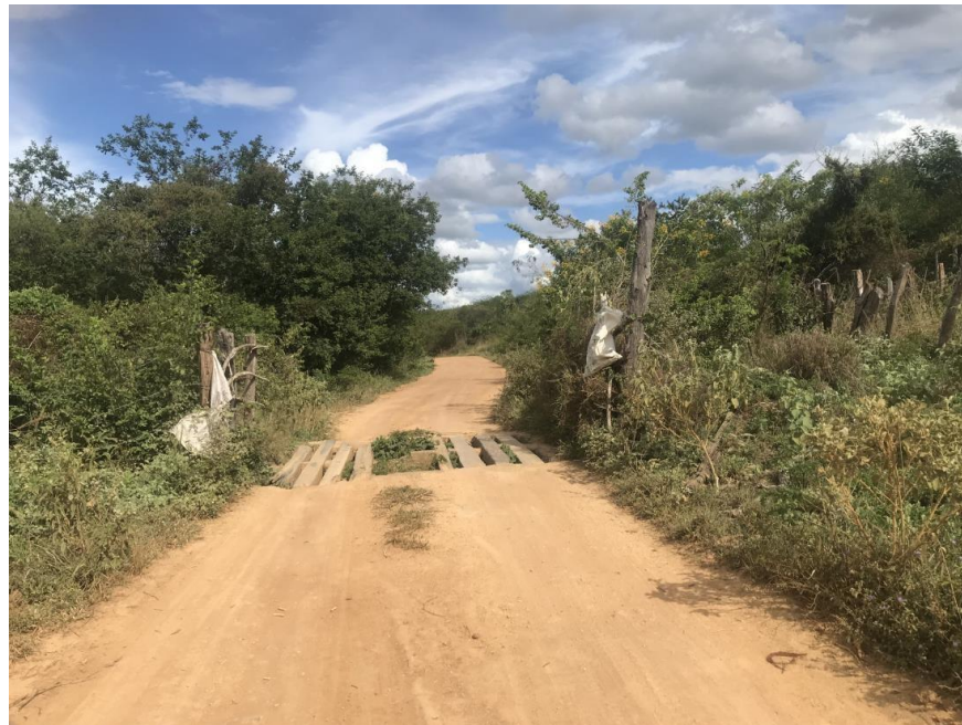
Figura 55: Trecho 03 - Mata burro a ser substituído - (Coord. 316705/ 8599888)
