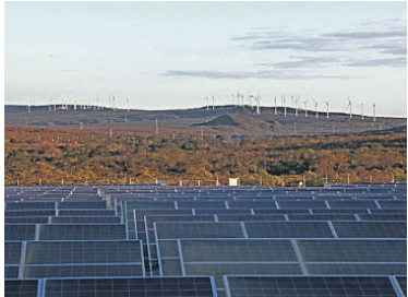
Cidade de Caetité conta com parque de energia solar
