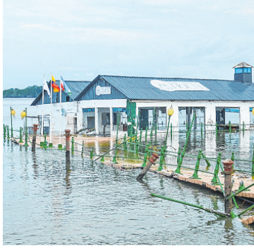
Doca foi destruída em Puerto Bolívar, Machala
