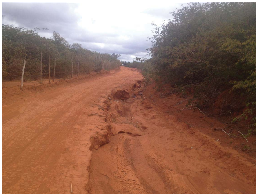
Vista de trecho a ser recuperado.
