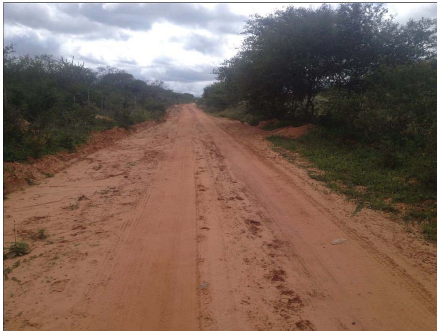
Vista de trecho a ser recuperado.
