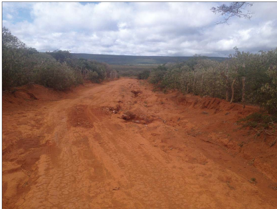
Vista de trecho a ser recuperado.
