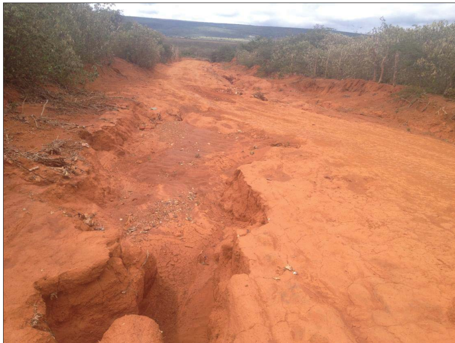
Vista de trecho a ser recuperado.
