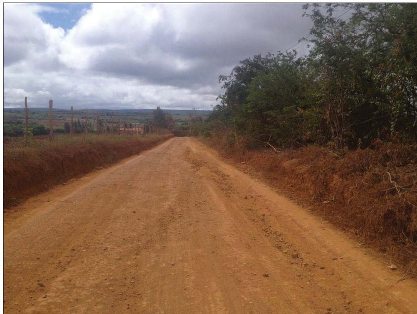
Vista de trecho a ser recuperado.
