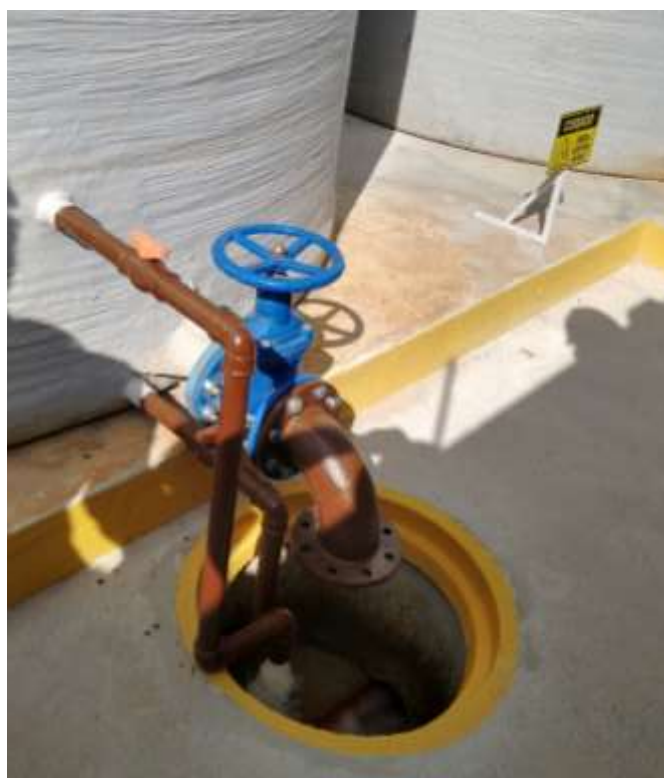
Figura 4: Registro Reator MBBR
