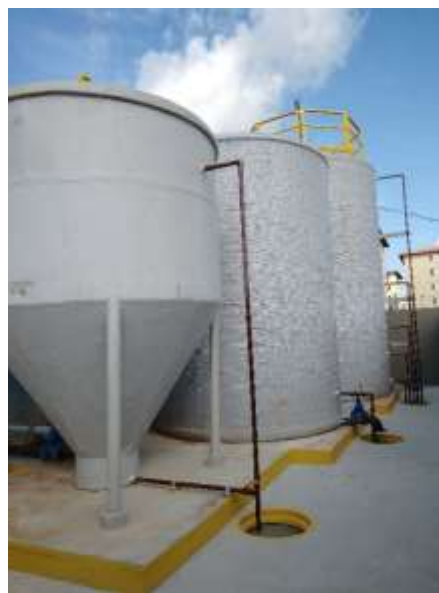
Figura 6: Decantador e Reatores MBBR
