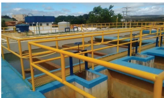
Foto 02 – Vista dos floculadores e decantadores
