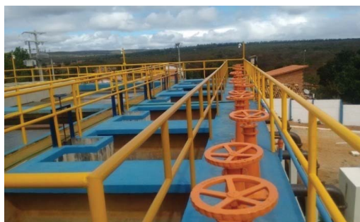
Foto 03 – Vista dos filtros
