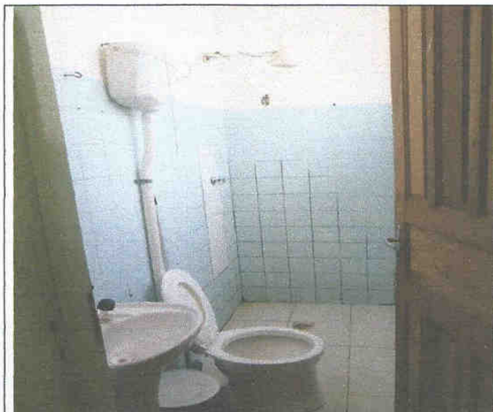
Figura 3: Banheiro Enfermaria Masculina D.
