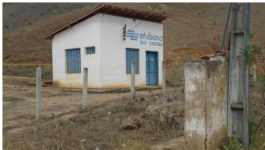
Foto 02: Captação do SAA de Cândido Sales / EEAB.
