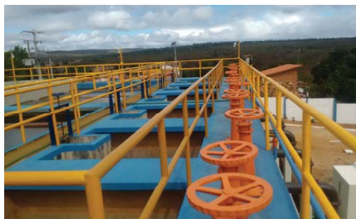
Foto 04 – Vista dos filtros
