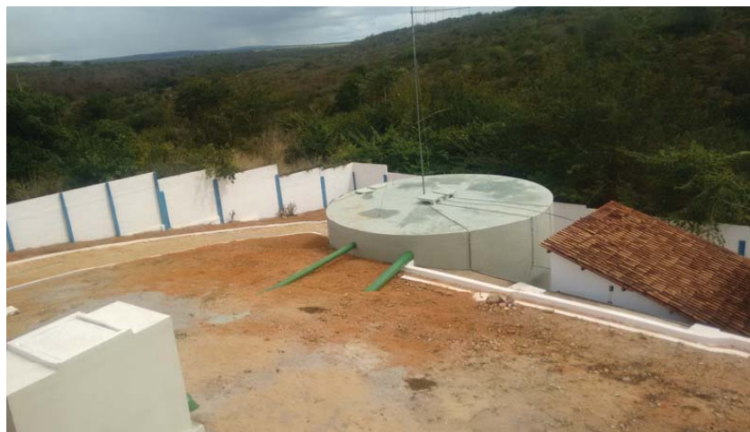
Foto 06 – Reservatório de distribuição localizado na ETA
