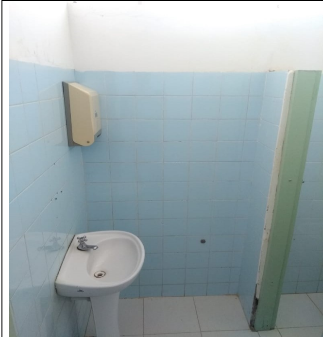
Figura 2.2: Pia de Banheiro Externo, Corredor
