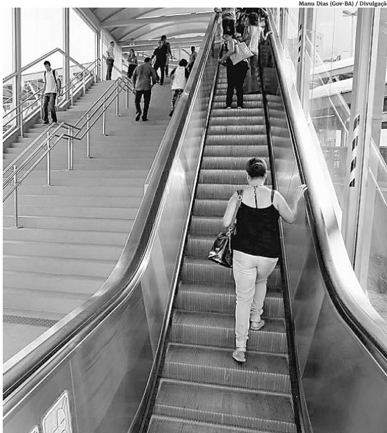
Escada rolante é uma das comodidades do equipamento na região da rodoviária
