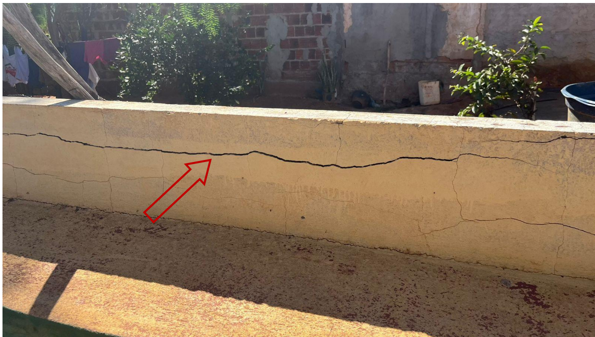
Cotenção a ser demolida e refeita
