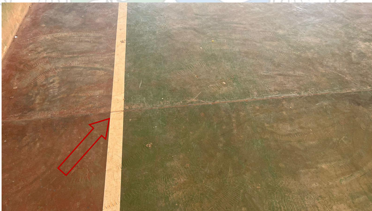
Piso a ser recuperado para recebimento de nova pintura
