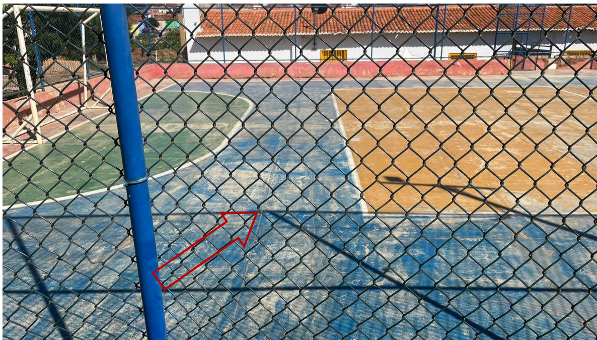
Pavimentação de quadra com fissuras a serem tratadas
