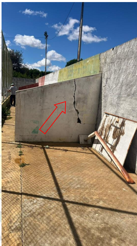
Alvenaria a ser recuperada
