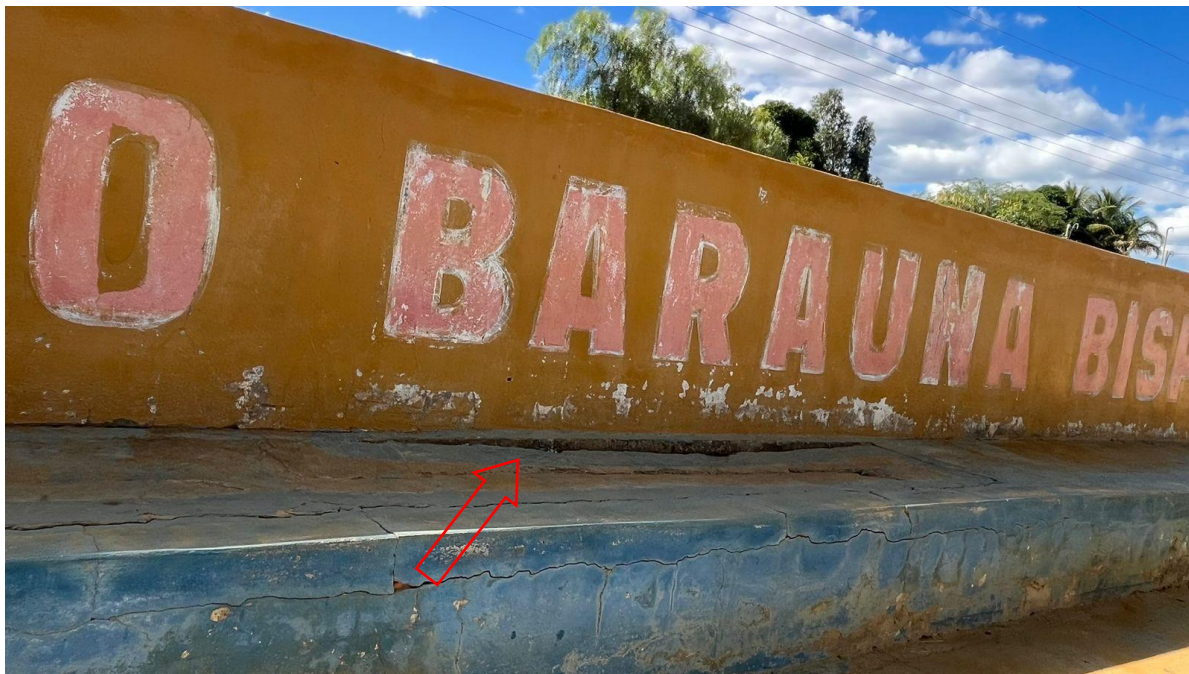
Laje a ser demolida e refeita
