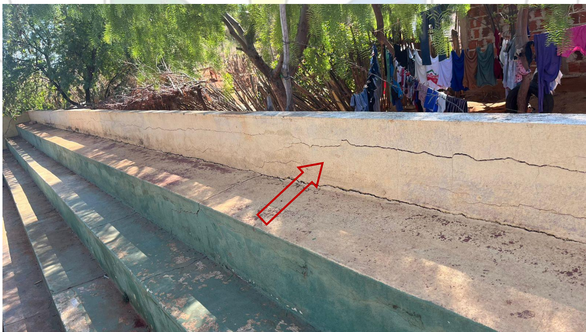
Cotenção a ser demolida e refeita
