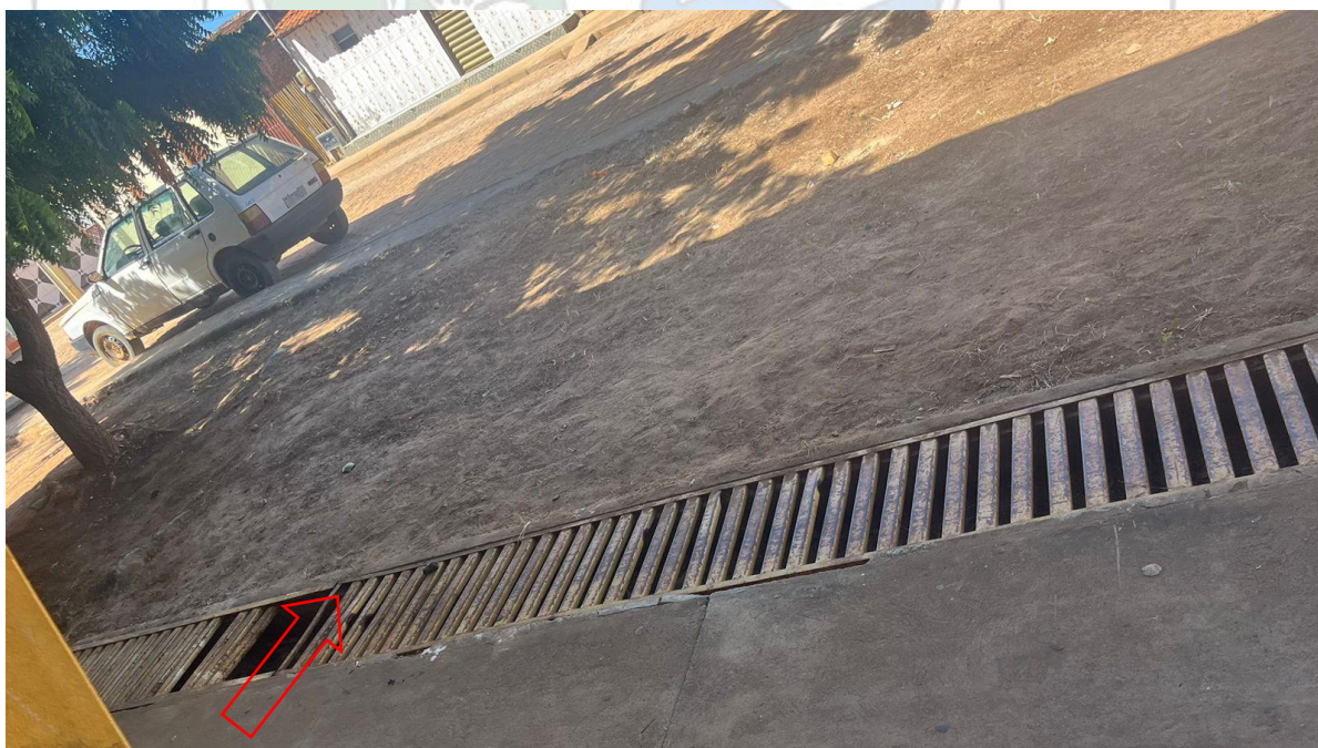
Grelhas do sistema de drenagem de águas pluviais a serem recuperadas.
