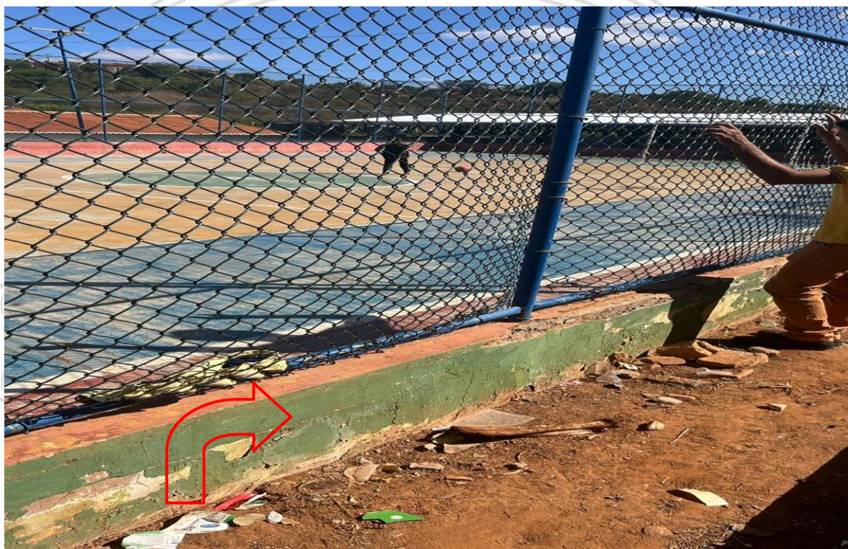
Mureta da quadra com necessidade de reparos
