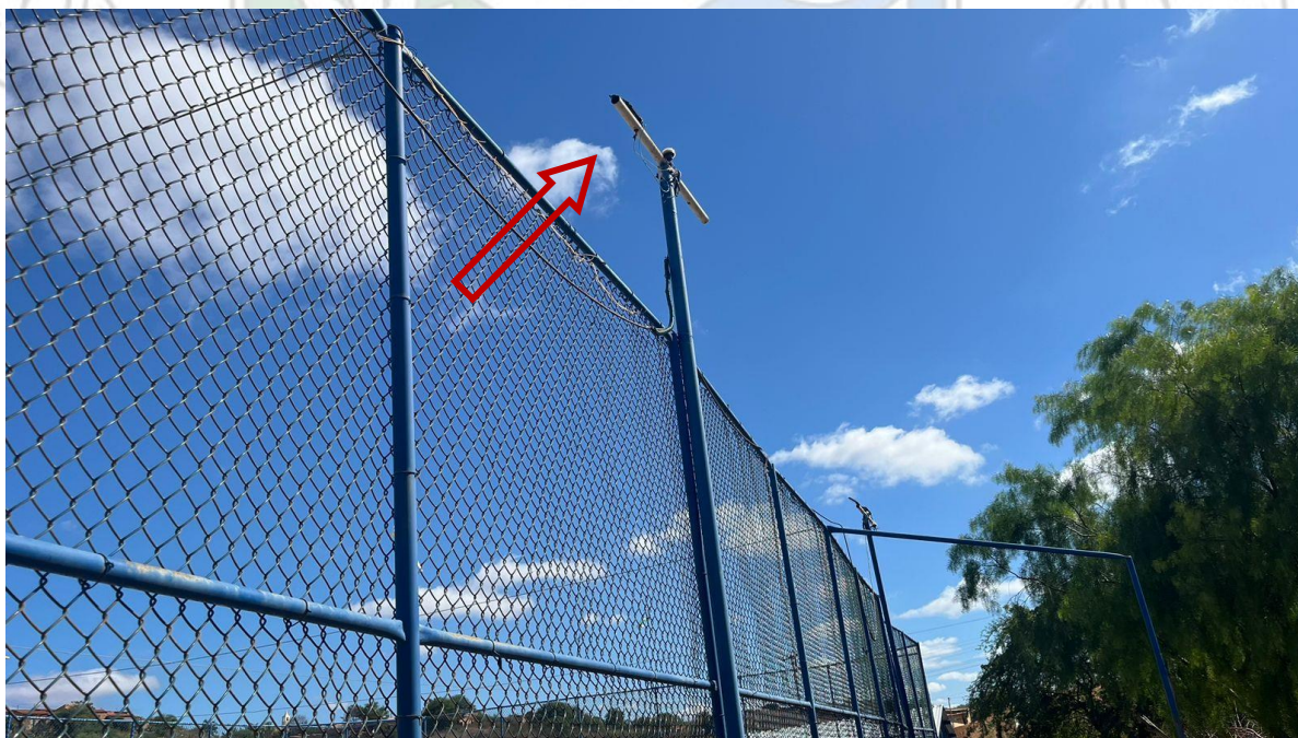
Leds a serem substituídos
