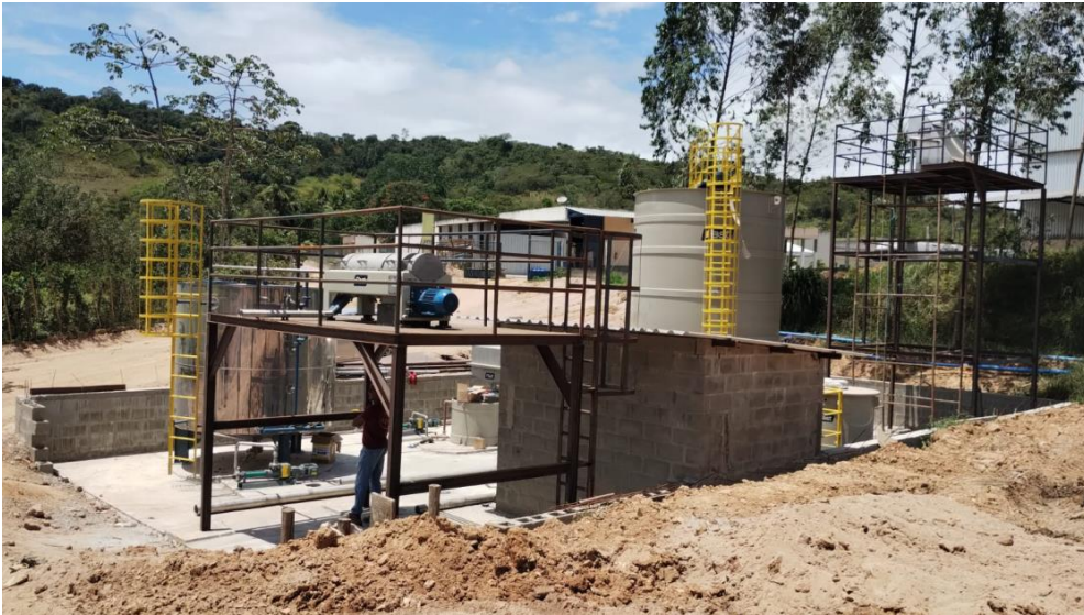
Foto 01: Implantação de sistema primário - flotador.
