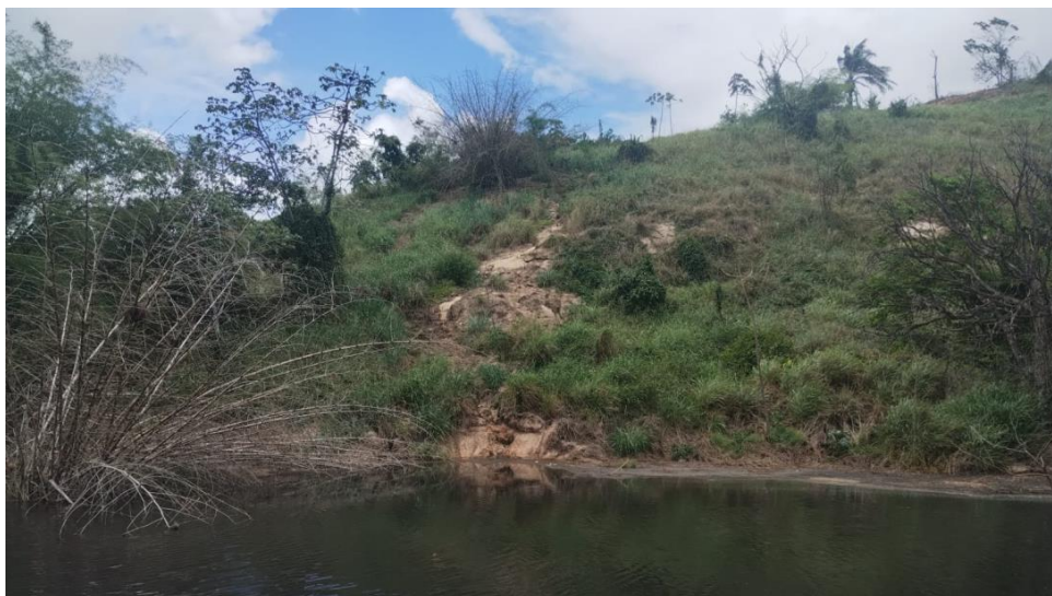
Foto 06: Talude da área de fertirrigação a ser recuperado.
