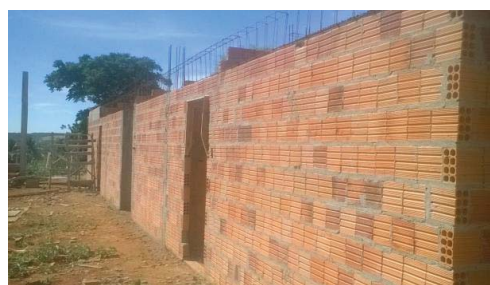
Foto 2 - Montagem das Ferragens com inconformidades.
