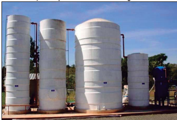
Figura 2.14 - Estação Compacta de Tratamento de Esgotos Sanitários.
