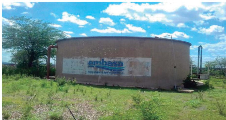
Figura 2.7 – Reservatório Apoiado na sede urbana.
