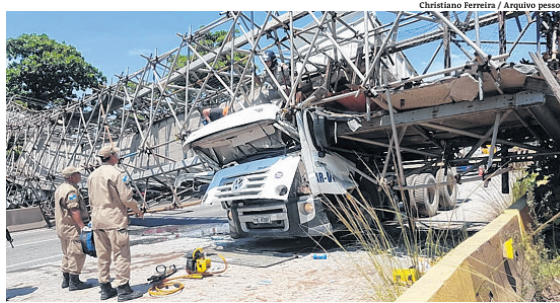
Caminhão ficou preso na estrutura que era provisória até a conclusão do projeto
