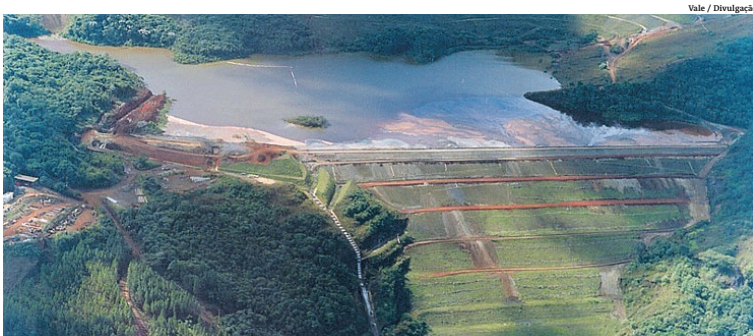
Barragem de Barão de Cocais (MG) está na lista de interdições da ANM, que inclui duas barragens na Bahia
