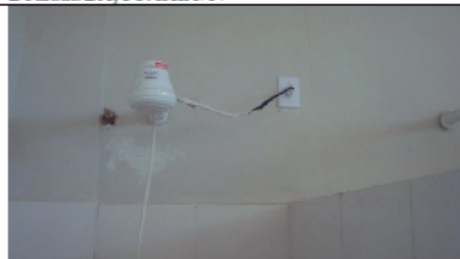
Foto 03 - Cabo elétrico do chuveiro já sem proteção externa em perfeito estado - América Dourada/BA, Fevereiro/2017.
