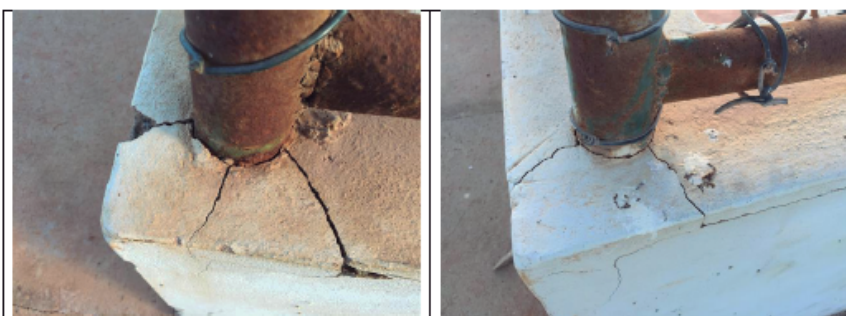
Fotos 5 e 6: A mureta não suportou adequadamente o montante vertical do alambrado e se rompeu. Quadra poliesportiva em Nova América, América Dourada/BA, em 29 de novembro de 2016.
