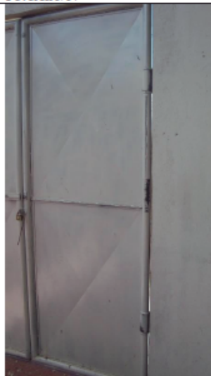
Foto 04 - Portão em aço aparentando ter quantidade de demãos insuficiente ou de má qualidade - América Dourada/BA, Fevereiro/2017.
