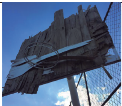
Foto 10: Tabela de compensado, material impróprio, deteriorado, irrecuperável. Quadra poliesportiva em Nova América, América Dourada/BA, em 29 de novembro de 2016.
