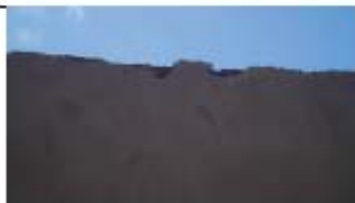
Foto 10 - Acabamento insatisfatório da parte superior da alvenaria do entorno da quadra - América Dourada, Fevereiro/2017.
