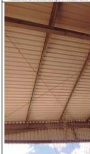
Foto 09 - Contraventamento da cobertura realizado fora das prescrições de projeto - América Dourada/BA, Fevereiro/2017.
