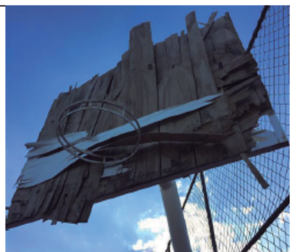
Foto 10: Tabela de compensado, material impróprio, deteriorado, irreversível. Quadra poliesportiva em Nova América, América Dourada/BA, em 29 de novembro de 2016.
