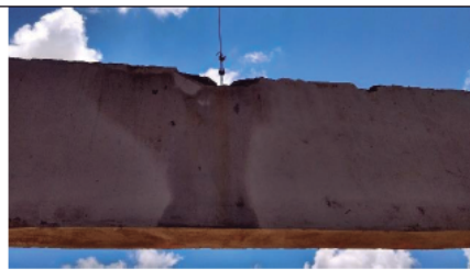
Foto 13 – Ausência de acabamento na ancoragem da tela de proteção da quadra – América Dourada/BA, Fevereiro/2017.
