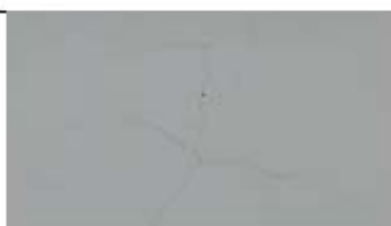
Foto 08 - Rachaduras em alvenaria - América Dourada/BA, Fevereiro/2017.
