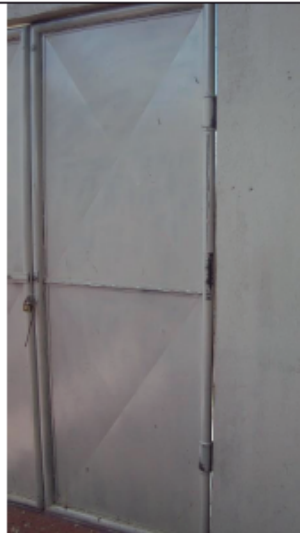
Foto 04 - Portão em aço aparentando ter quantidade de demãos insuficiente ou de má qualidade - América Dourada/BA, Fevereiro/2017.
