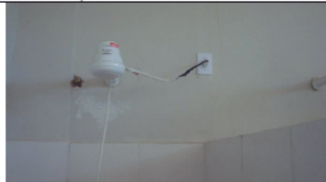
Foto 03 - Cabo elétrico do chuveiro já sem proteção externa em perfeito estado - América Dourada/BA, Fevereiro/2017.
