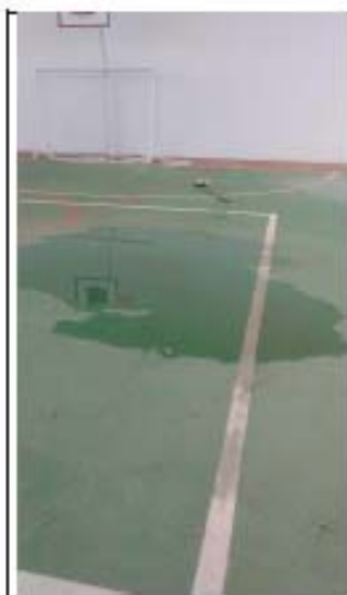
Foto 07 - Acúmulo de água de chuva no piso da quadra - América Dourada/BA, Fevereiro/2017.
