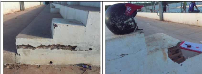
Fotos 3 e 4: Arquibancada com defeitos na alvenaria Quadra poliesportiva em Nova América, América Dourada/BA, em 29 de novembro de 2016.
