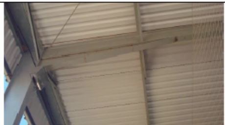
Foto 05 - Solda dos perfis do pórtico apresentando sinal prematuro de corrosão - América Dourada/BA, Fevereiro/2017.
