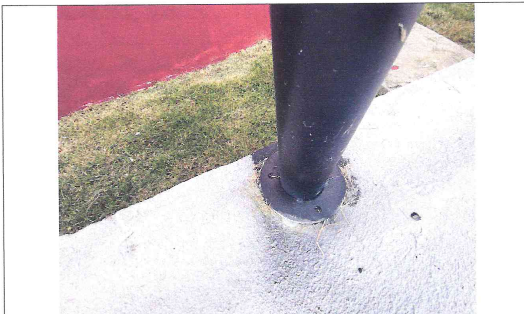
Foto 04: Guarda corpo com ausência de parafusos de fixação.
