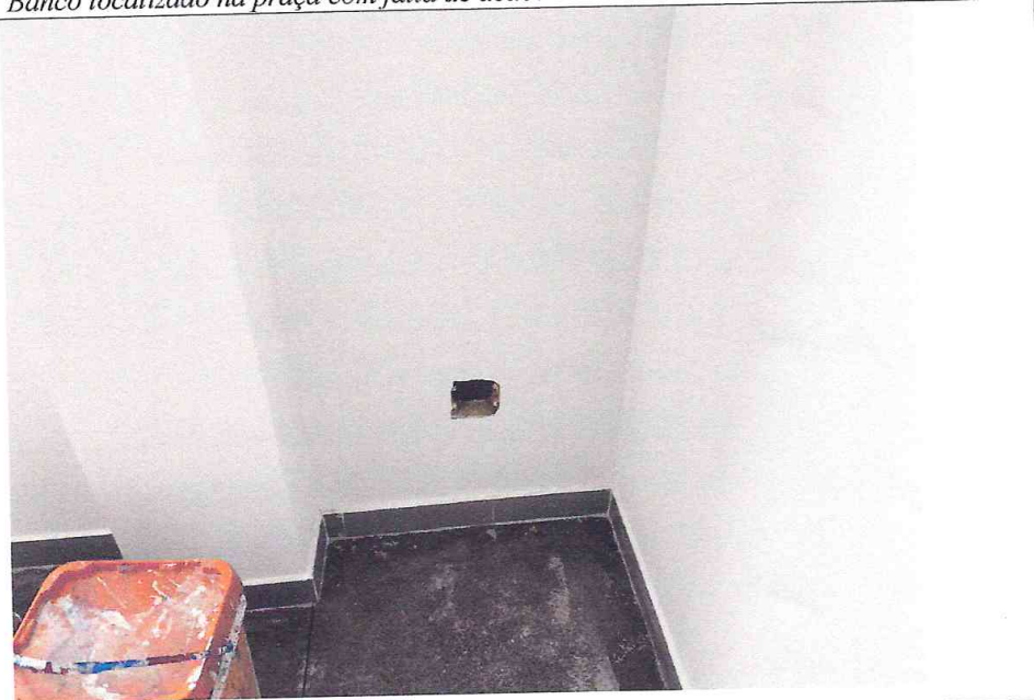
Foto 03: Caixa elétrica (4x2) sem fechamento.
