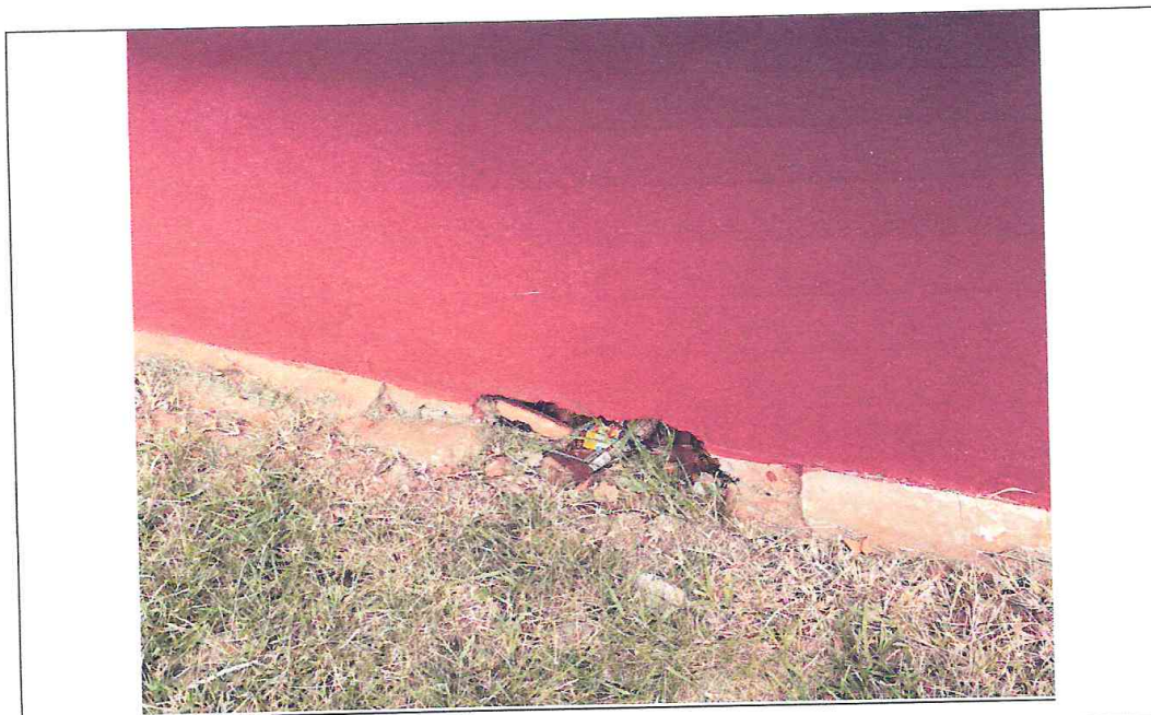
Foto 02: Banco localizado na praça com falta de acabamento.
