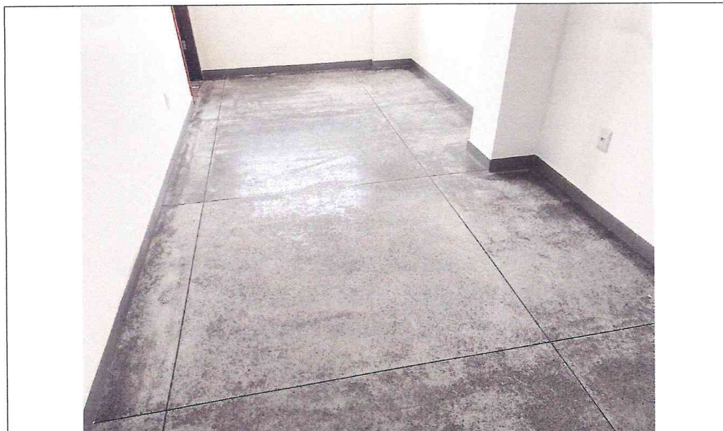
Foto 10: Piso com imperfeições e juntas de dilatação apresentando deslocamento.
