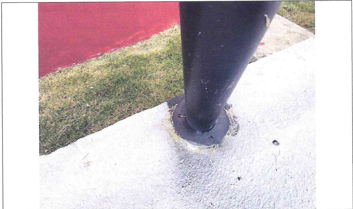
Foto 04: Guarda corpo com ausência de parafusos de fixação.
