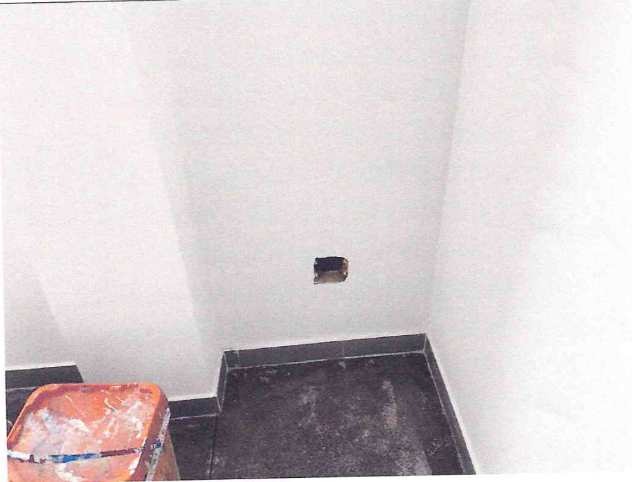
Foto 03: Caixa elétrica (4x2) sem fechamento.
