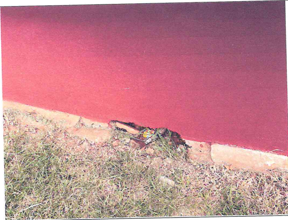
Foto 02: Banco localizado na praça com falta de acabamento.
