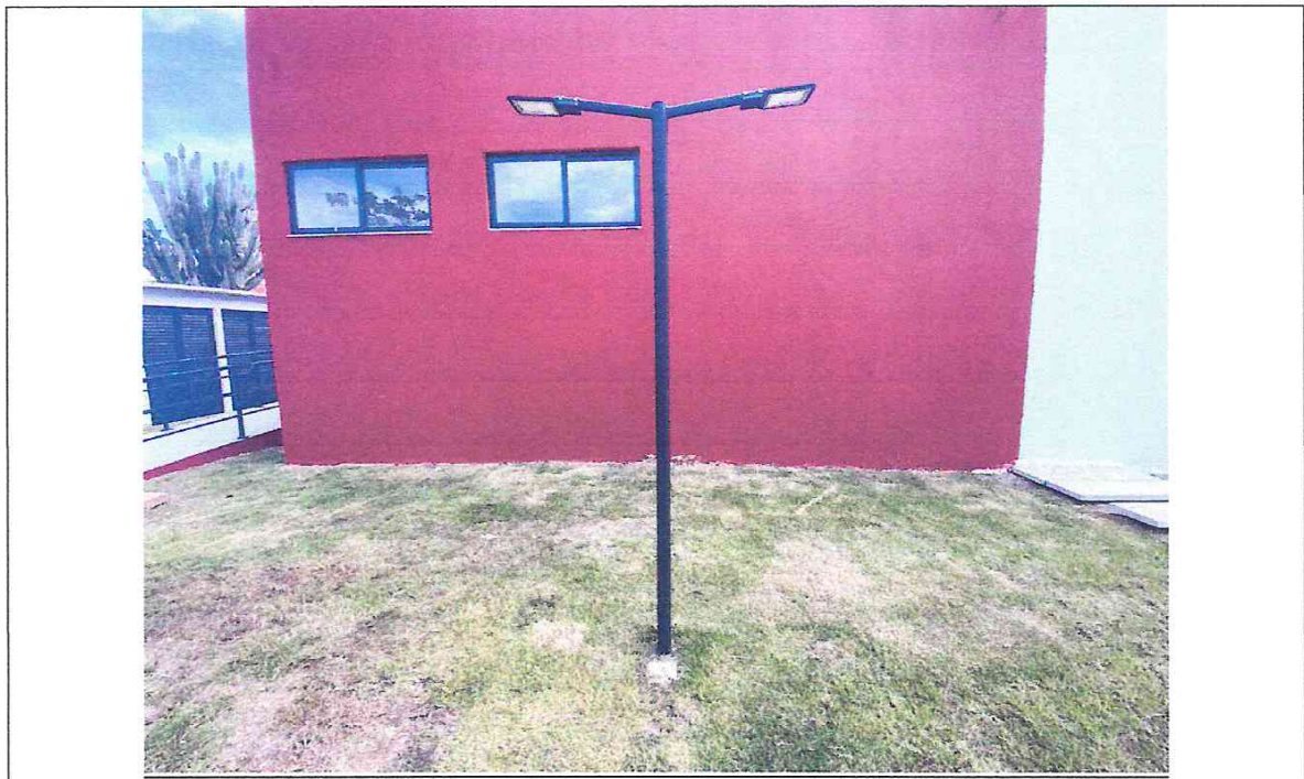
Foto 01: Poste com má fixação.
