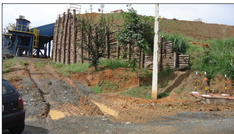
Foto 3. Sistema de contenção na área de alimentação do Britador.
