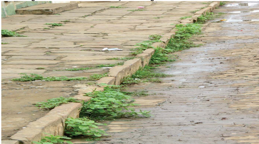
Figura 18: Problemas nos serviços de congêneres em Várzea do Cedro
