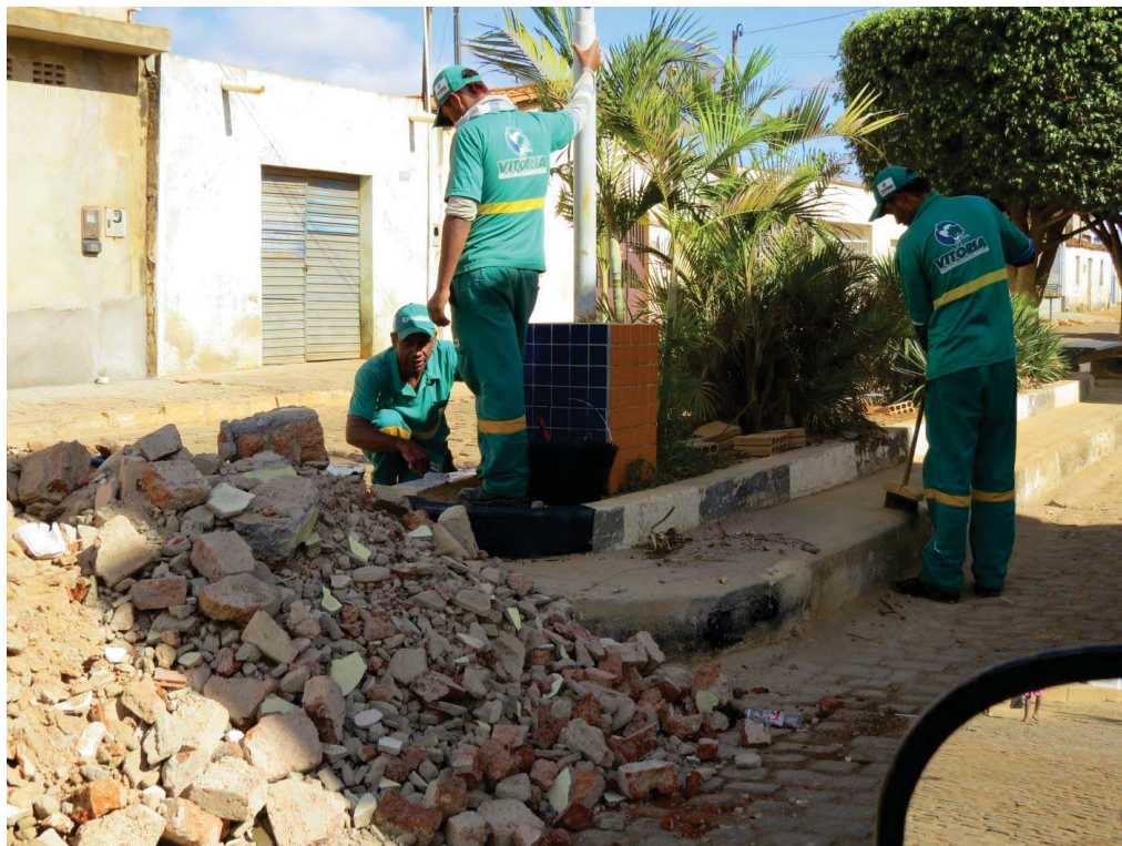
Figura 11: Problemas em relação aos serviços de construção civil
