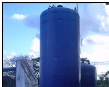
Foto 18 - Filtro de pressão
